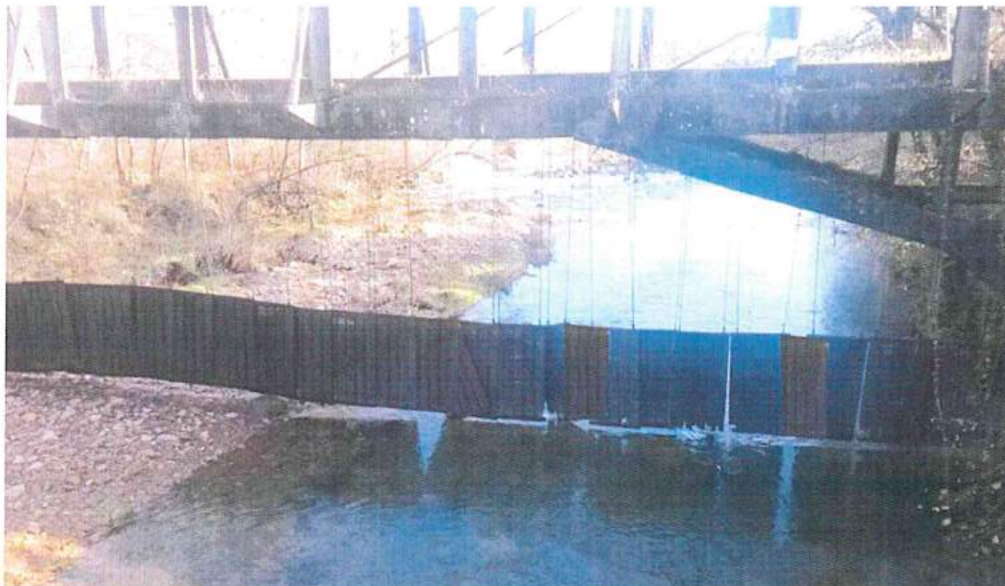
Fig. 9: Paratoie di contenimento degli ungulati.
